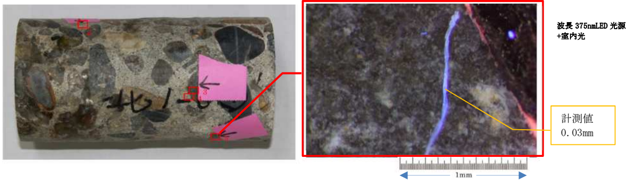
写真-2 ひび割れ幅計測写真
