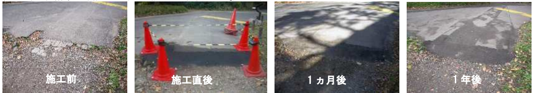
写真-2 段差箇所の経年変化
