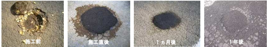
写真-1 ポットホール補修箇所の経年変化
