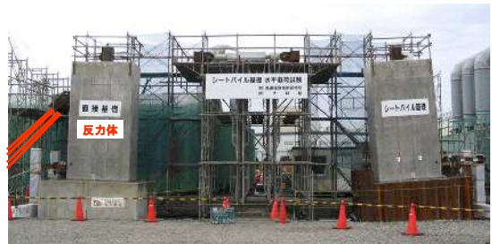
写真-2 シートパイル基礎水平载荷試験 (日経コンストラクション 2004.12.10 号掲載)
