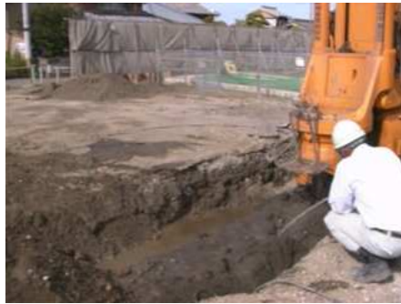
写真-2 沈下状況 (1)
