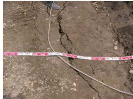
写真-3 沈下状況 (2)
