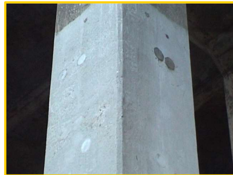
脱塩を適用した橋脚の状況 旧国道8号線洞川橋経年比較
