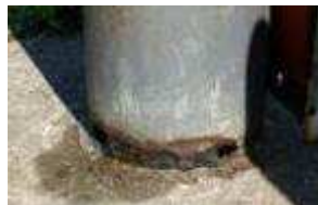
施工前：根入れ部で劣化した鋼管柱
