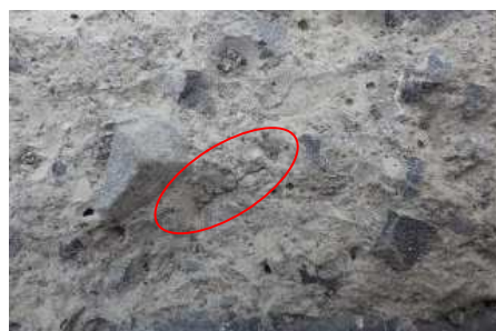
写真-8 はつり後クラック発生状況
