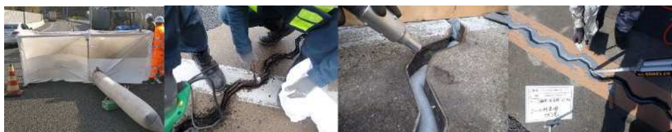
①飛散防止対策 → ②止水材撤去 → ③ブラスト処理 → ④シーラ材充填
