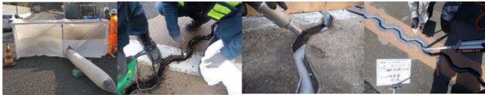
①飛散防止対策 → ②止水材撤去 → ③ブラスト処理 → ④シーラ材充填
