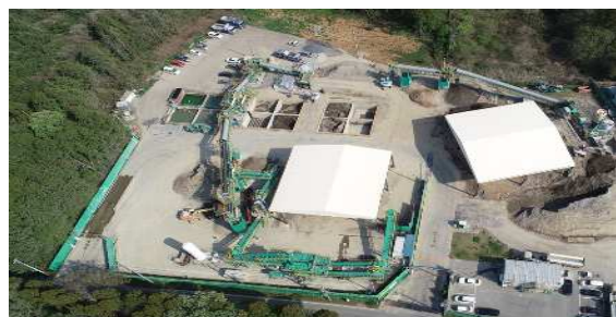
写真-1 JRC再生土プラント全景
