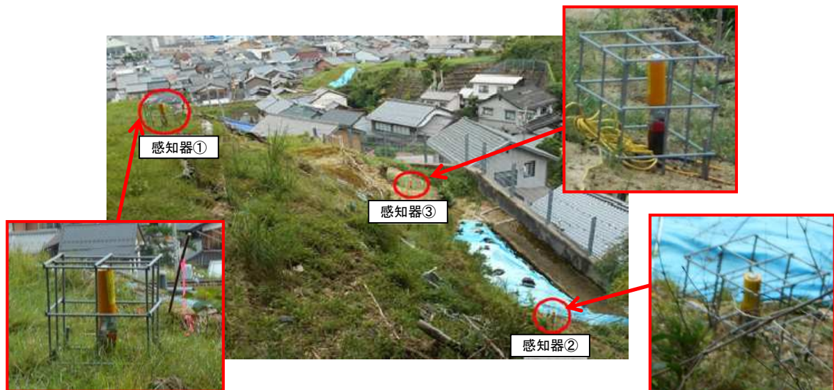
写真1 スーパーサッチャー 感知器 設置事例 (住宅密集地裏山、外側の鉄筋格子は獣害防止のため)
