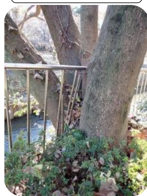
構造物巻き込み
