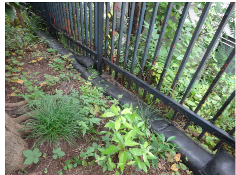
写真9：雨水・土砂の流出対策 令和6年(2024)10月
