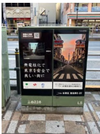
地上機器のラッピング
