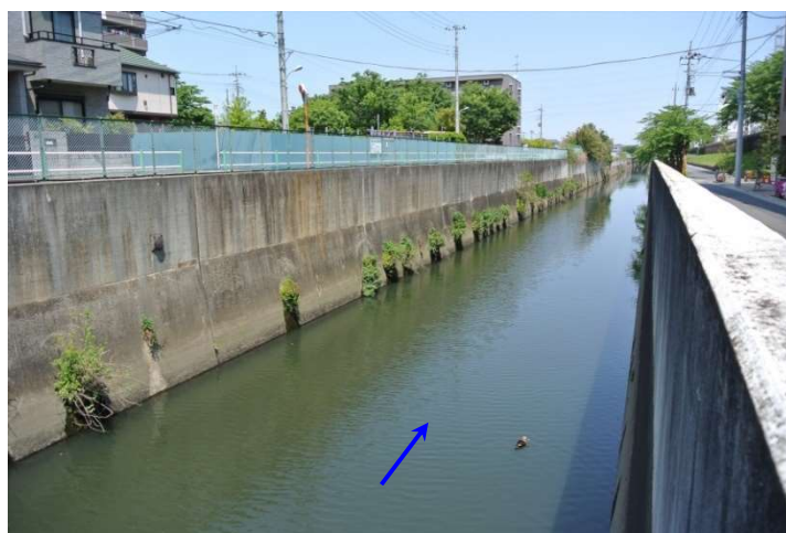
写真 4-5 水道橋上流の状況。護岸高不足区間（板橋区三園二丁目付近）
