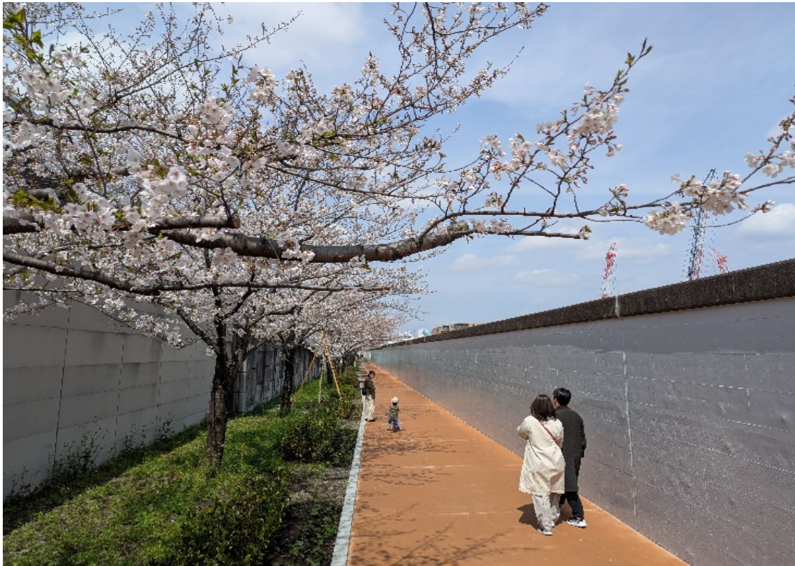
新河岸川緑化工事整備 （板橋区東坂下二丁目地内） ～河川管理用通路の緑化状況～
