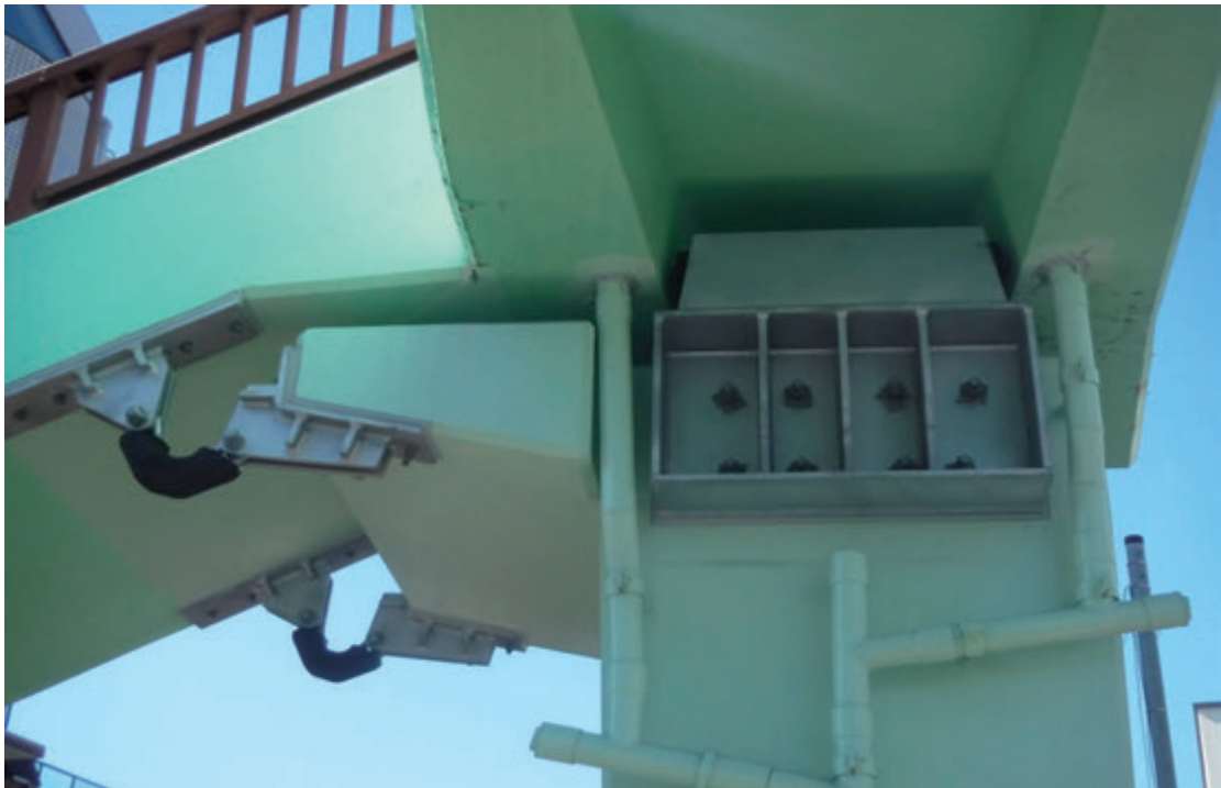
横断歩道橋の耐震補強工事 主要地方道千代田練馬田無線（第8号）目白通り（南長崎五丁目歩道橋） （豊島区南長崎五丁目）
