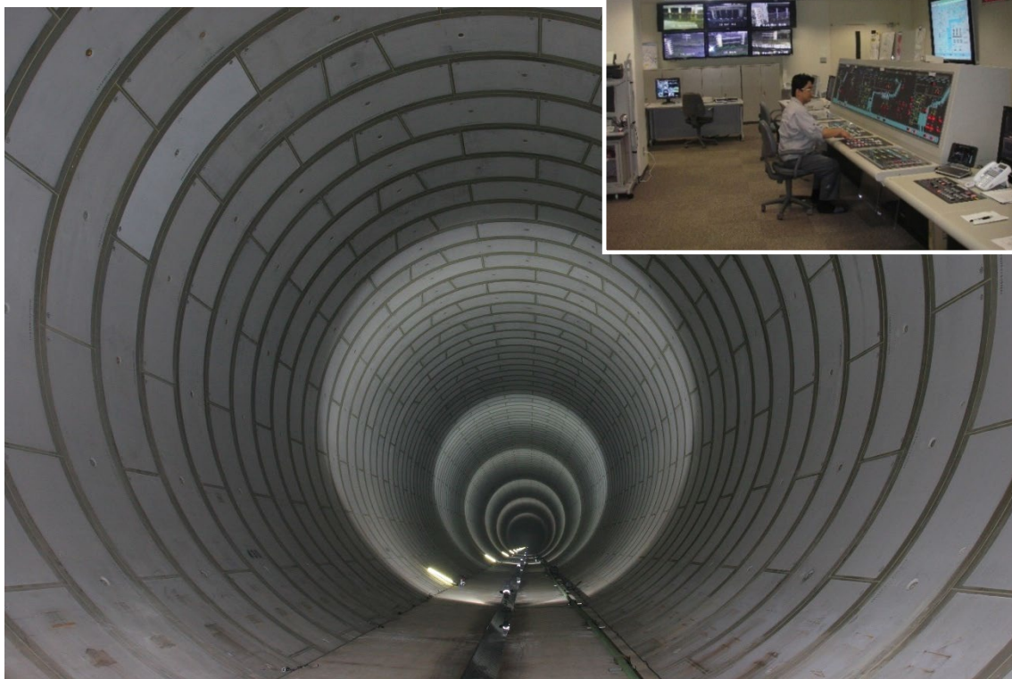
神田川・環状七号線地下調節池(稼働中) 本体トンネルと遠方監視操作システム 神田川、善福寺川および妙正寺川の3河川から洪水を取水して、このトンネル内に貯留します。 各河川の水位監視や取水の際のゲート操作等は、第三建設事務所及び善福寺川取水施設の監視室で行います。
