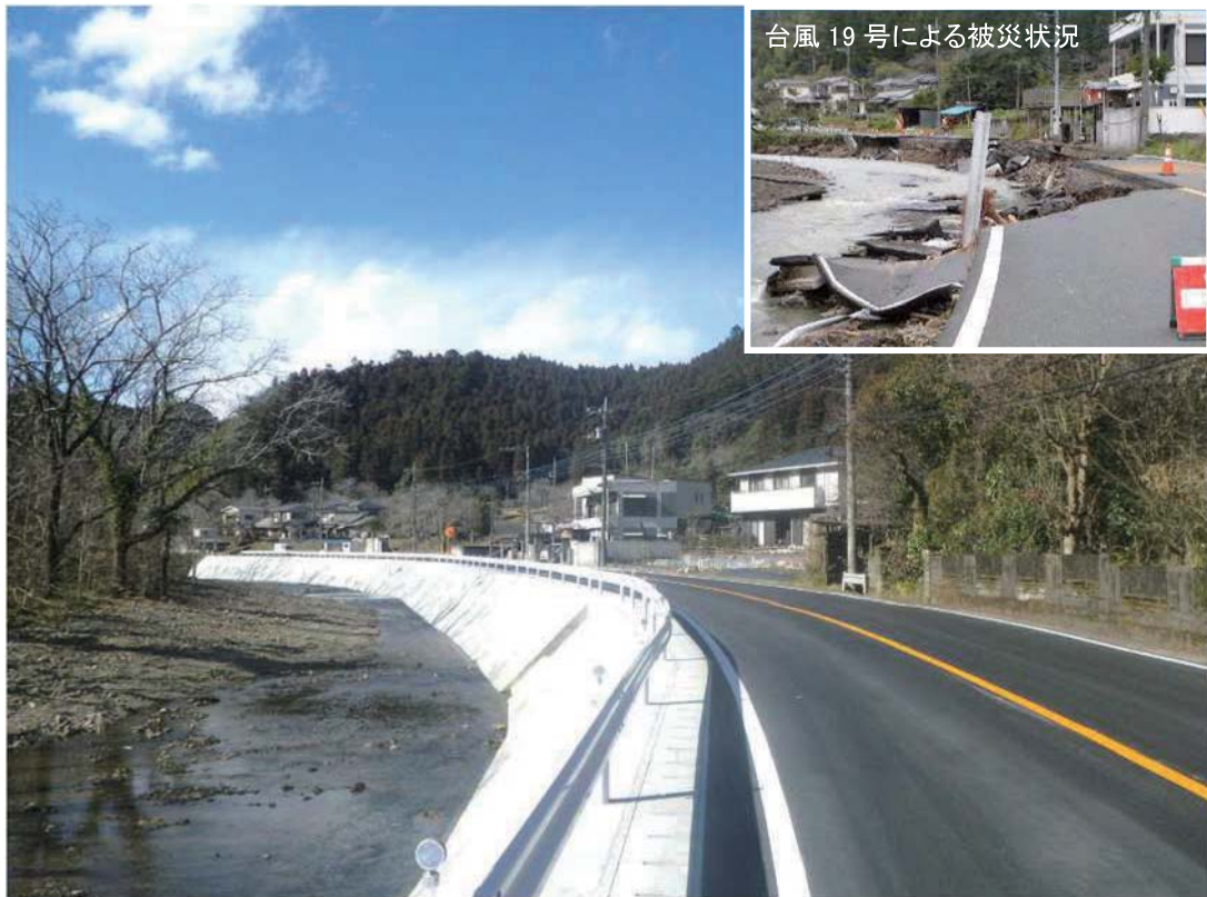
道路災害復旧事業 「一般都道奥多摩あきる野（第 184 号）」 西多摩郡日の出町大久野地内 令和 3 年 2 月完成
