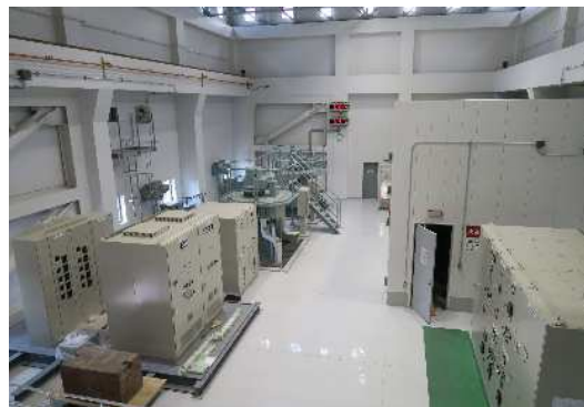
(対策工事後：機場内ポンプ設備)
