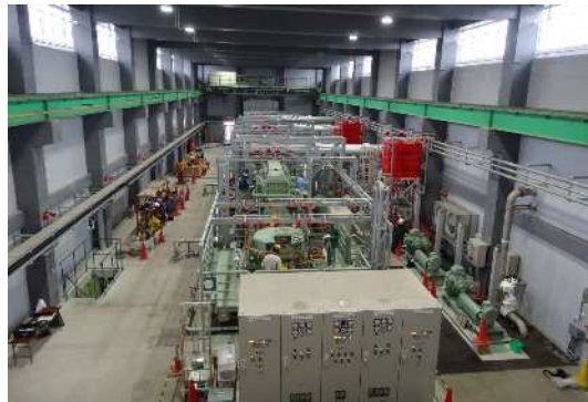
(対策工事後：機場内ポンプ設備)
