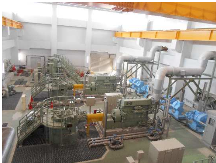
木下川排水機場内部
