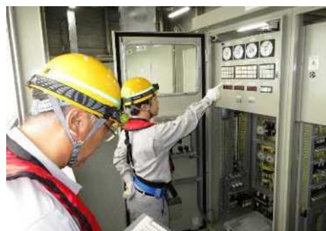
電気設備点検
