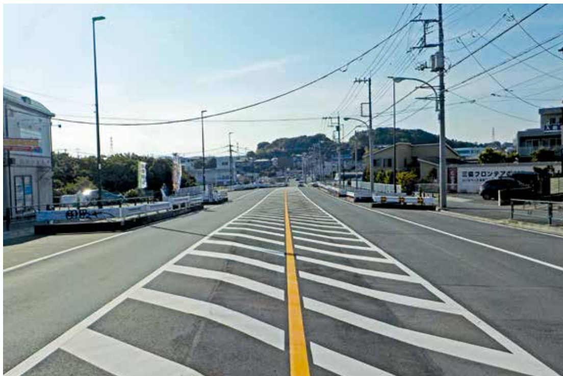
○主要地方道府中町田線（第18号）鎌倉街道【本町田Ⅱ期】 街路築造工事及び電線共同溝設置工事を実施
