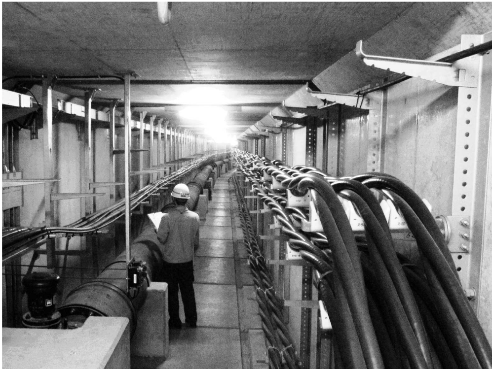
立川共同溝内部
