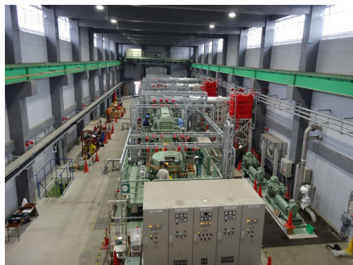
(対策工事後：機場内ポンプ設備)
