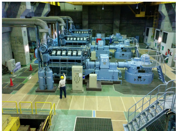
木下川排水機場内部
