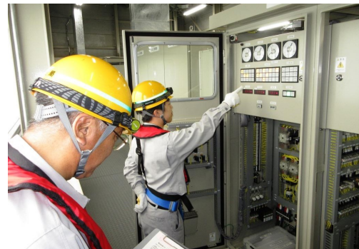
電気設備点検
