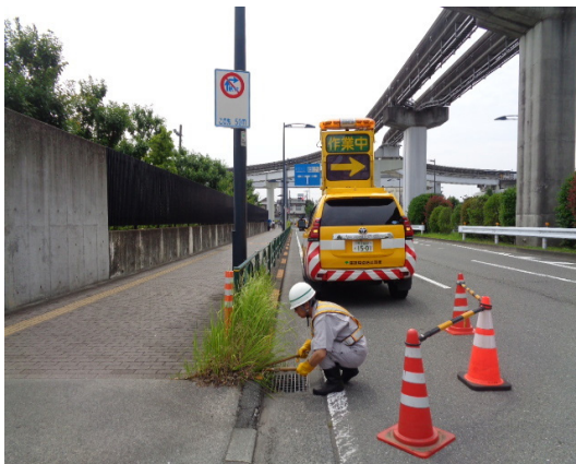
巡回点検 巡回点検班による応急対応
