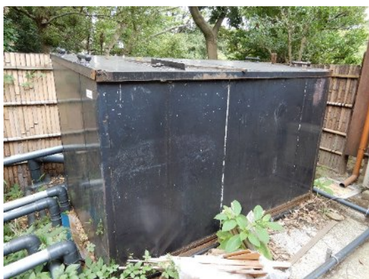
図 3-23：濾過装置 （令和元年 7 月 5 日）
