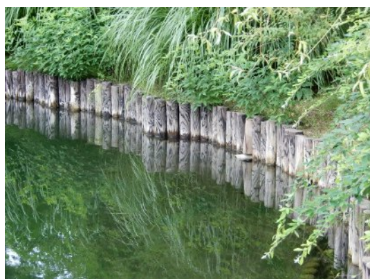
図 3-26：池の乱杭護岸（拡大） （令和元年 7 月 5 日）
