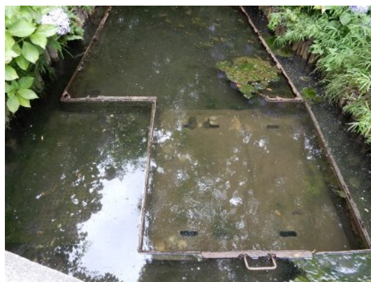
図 3-24：濾過装置（マイクロストレーナー） （令和元年 7 月 5 日）
