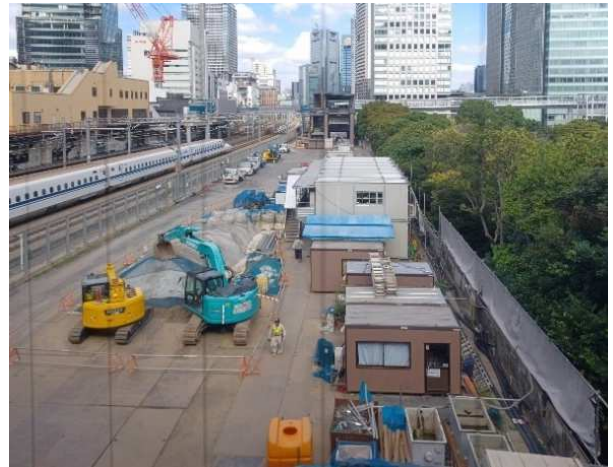
⑥西側に隣接する歩行者専用道第1号線整備予定地 (令和6(2024)年10月撮影)
