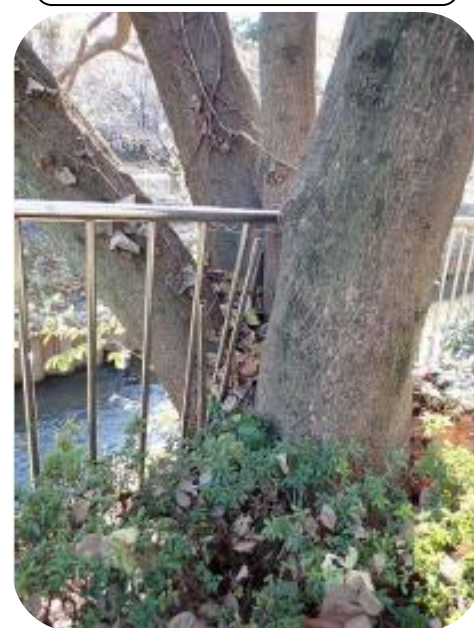
構造物巻き込み
