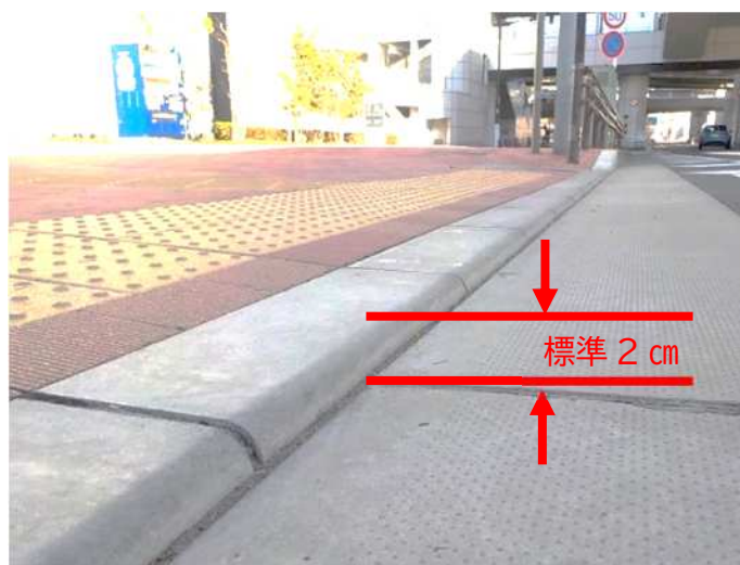
図 4-4 横断歩道部の段差
