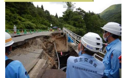
【令和4年8月の大雨】 (山形県米沢市)
