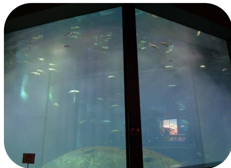
亚克力パネルの白濁、接着部の劣化
