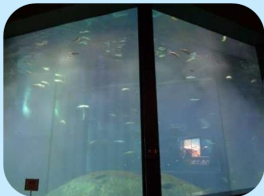
アクリルの白濁、接着部の劣化
