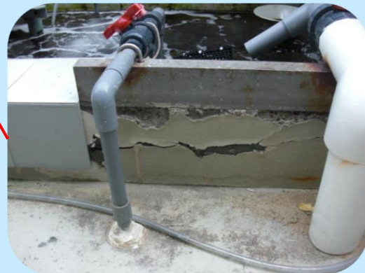
コンクリート（水槽）の劣化
