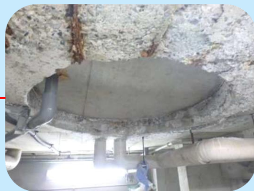
鉄筋の腐食、コンクリートの劣化
