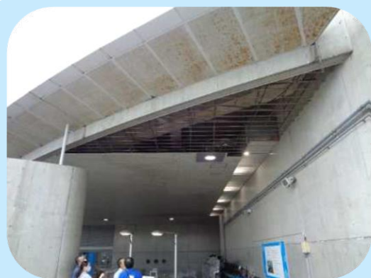
天井下地の腐食 ※R5.3現在改修済
