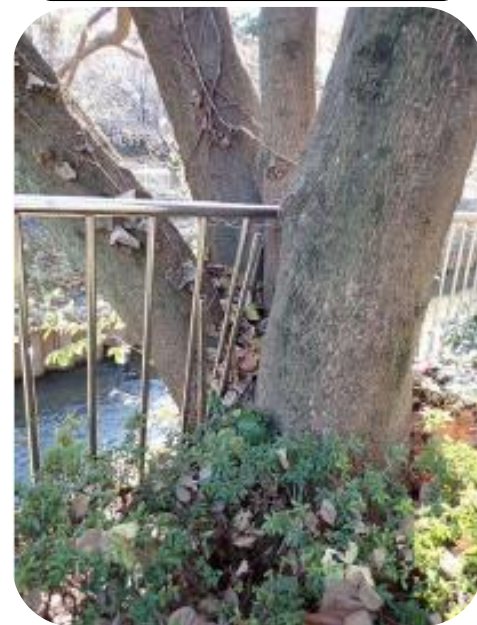
構造物巻き込み
