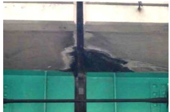
写真３－２ ＲＣ床版、端部張り出し部の損傷事例
