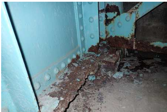
写真３－１ 鋼桁端部の損傷事例
