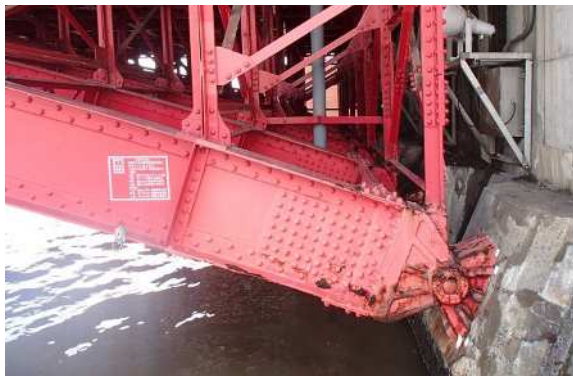
海水による鋼アーチ部材の腐食
