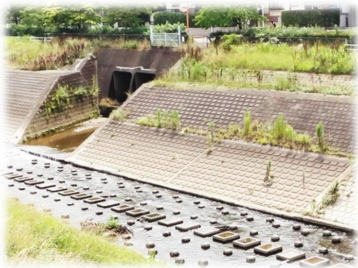
護岸の老朽化
