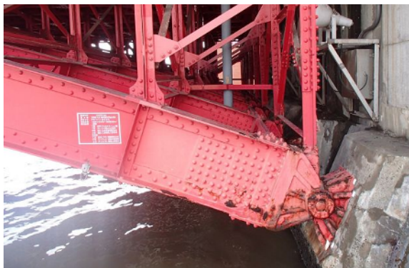
海水による鋼アーチ部材の腐食
