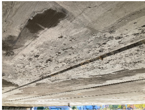
アルカリ骨材反応による主桁コンクリートのひび割れ
