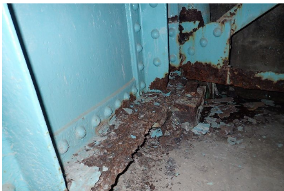
写真３－１ 鋼桁端部の損傷事例
