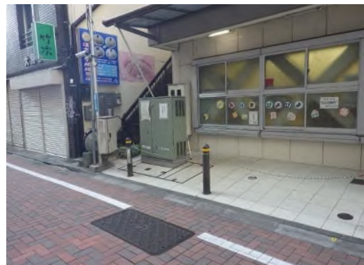
図 4-11 公共用地等への地上機器設置事例
