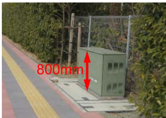
図 11-6 地上機器のコンパクト化 （出典：無電柱化推進のあり方検討委員会資料（令和8年4月 国土交通省））
