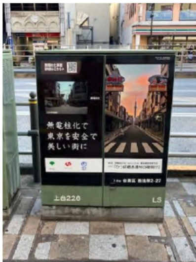
地上機器のラッピング
