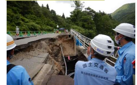
【令和4年8月の大雨】 (山形県米沢市)
