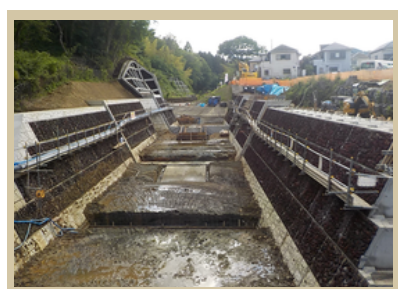
現場では河床にある1.5mの段差を0.5mずつ3段に分けた堰を整備中（お魚が自由に通れる道も付加）
