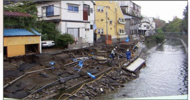
護岸が崩壊した妙正寺川
