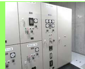
受変電設備(高圧受電盤)
