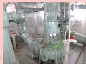
排水設備(主排水ポンプ)
