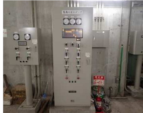
機側操作盤（環七・神田川取水施設）
