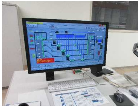
監視操作卓（荏原調節池）
