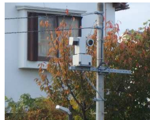
監視カメラ（黒目橋調節池）
