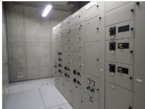
コントロールセンタ（環七・善福寺川取水施設）
