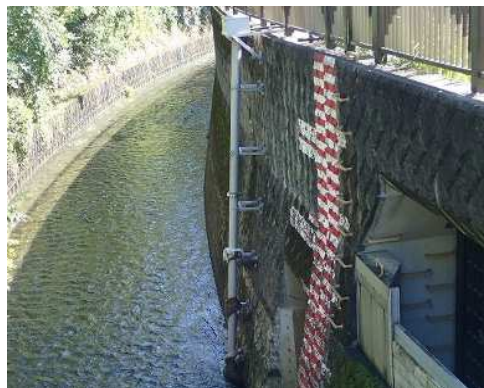
水位計（妙正寺川第二調節池）
