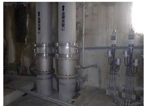
流量計（白子・白子川取水施設）
