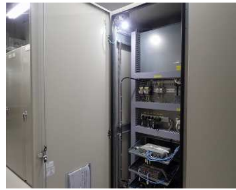
伝送装置（古川・排水施設）
