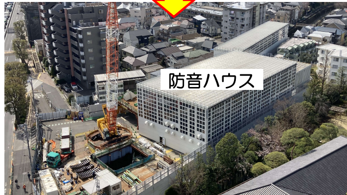
シールド設備設置および 防音ハウス組立工事の状況事例 (妙正寺川取水施設※シールド発進立坑)
