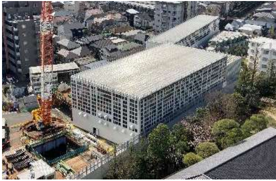
防音ハウス完成後の事例 (妙正寺川取水施設)
