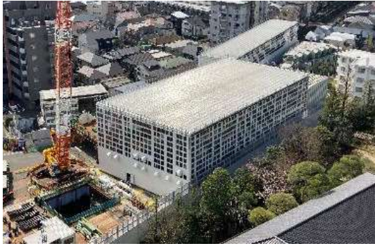
妙正寺川取水施設の防音ハウス
