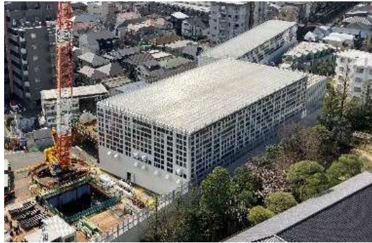
妙正寺川取水施設の防音ハウス
