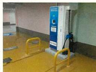
【電気自動車用急速充電器】
