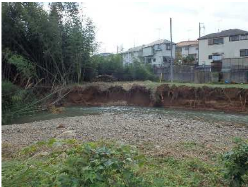
H29.10月 堀口橋下流右岸崩壊
