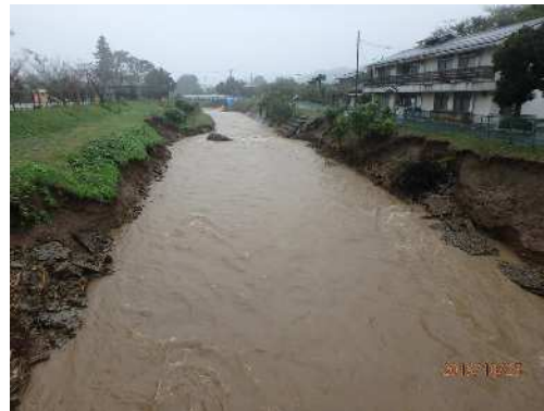
R元.10月 堀口橋上流兩岸崩壊
