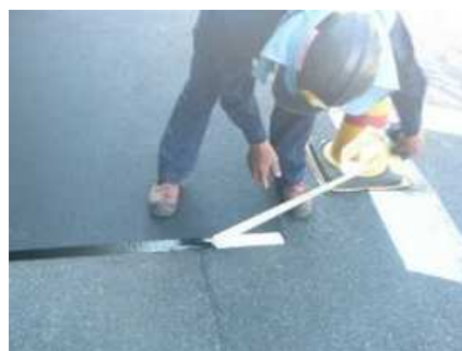
写真-2 シールコート工 既設アスファルトにアステープドットを貼り付け、剥離紙をはがしているところ
