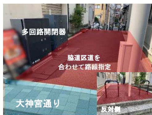
写真—1 脇道区道の地上機器
