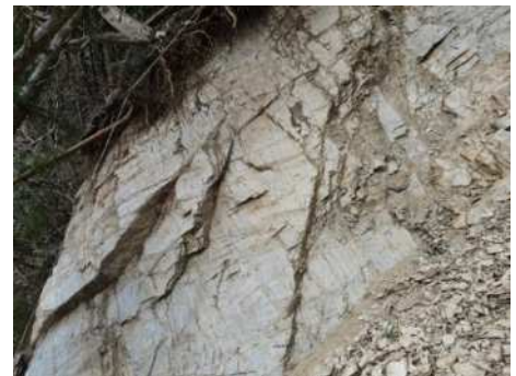
写真-2 崩落面の状況
