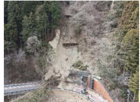
写真-1 被災直後の現場状況
