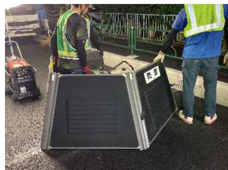
写真－３ 防音パネル
