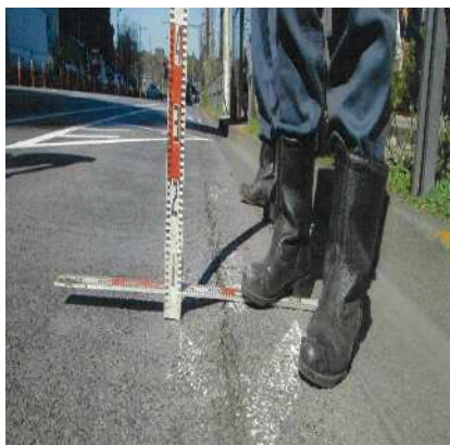
写真－2 路面の落込み状況
