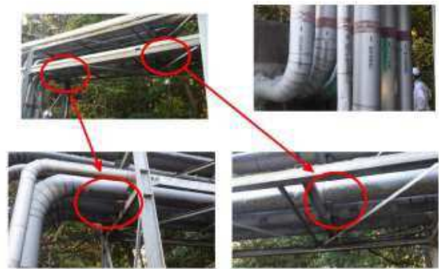
写真 17 清掃工場側での高温水の漏水発生
