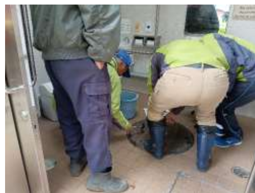
写真9 防災トイレ設置確認
