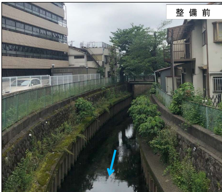
川幅が狭く、流下能力が不足
