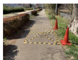
根上がり段差箇所
